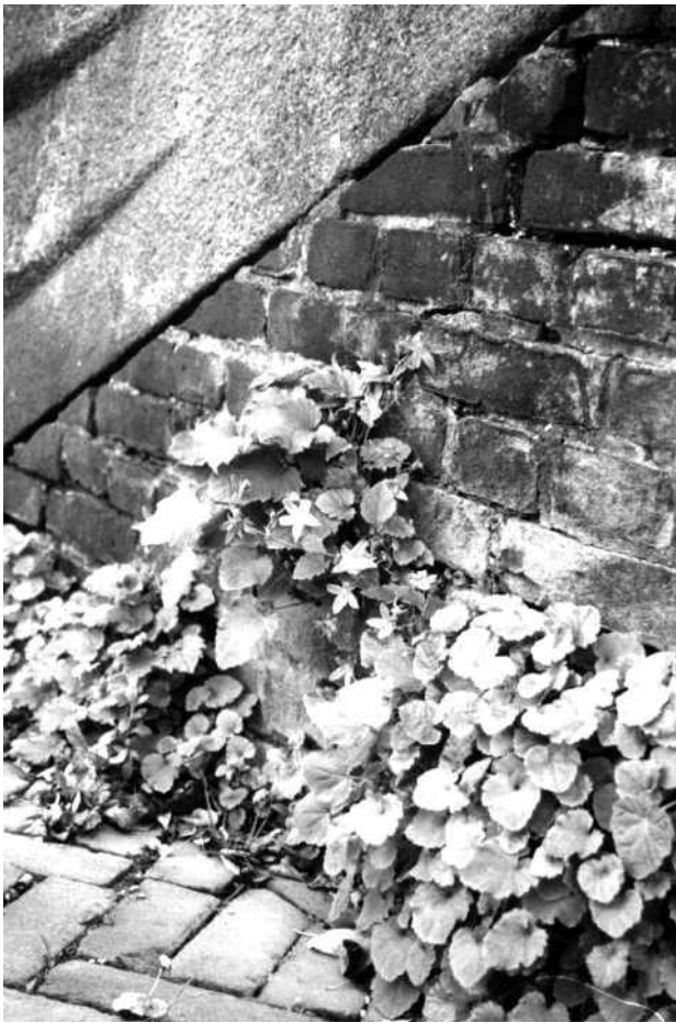
Foto 2. Dof muurklokje op de Herewegviaduct
